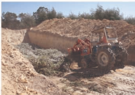
Destruição de plantas de viveiro por enterramento com adição de cal viva
